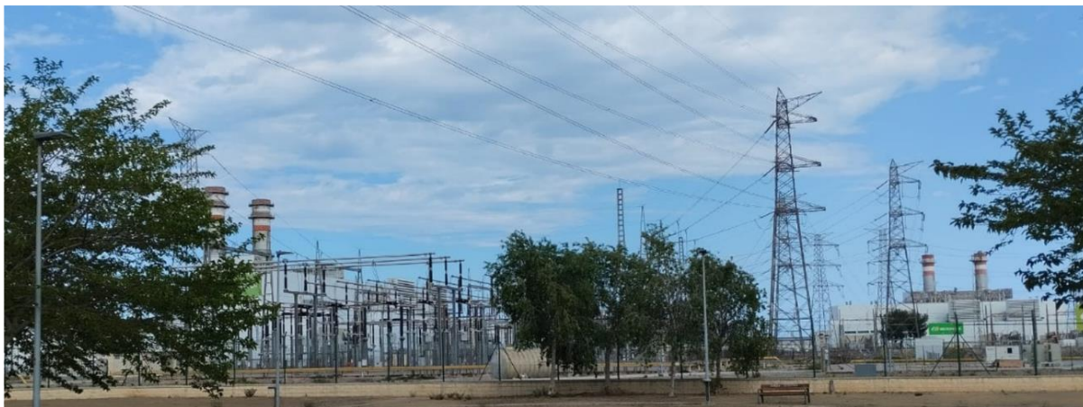
Figura 5 Fotografía de 2 de las líneas aéreas de 400Kv ubicadas junto a la central térmica de Iberdrola.
