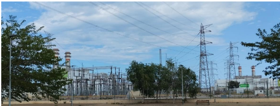
Figura 29 Fotografía de la salida de las 2 líneas de 400 Kv desde la ST Castellón y ST Serrallo ubicadas junto a la central térmica de Iberdrola.
