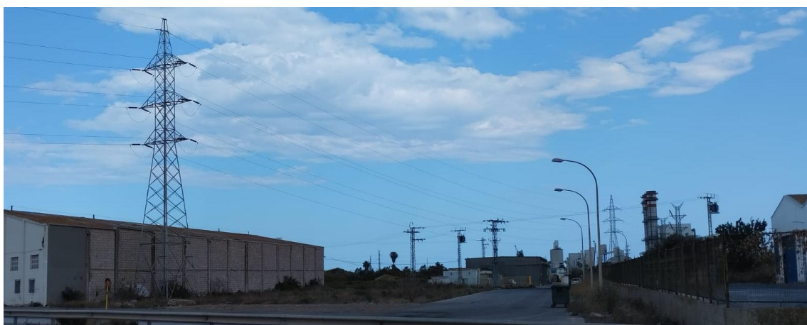
Figura 30 Fotografía de la línea nº 3 de 132 kV y un apoyo, así como de varias líneas de distribución en media tensión a 20 Kv.
