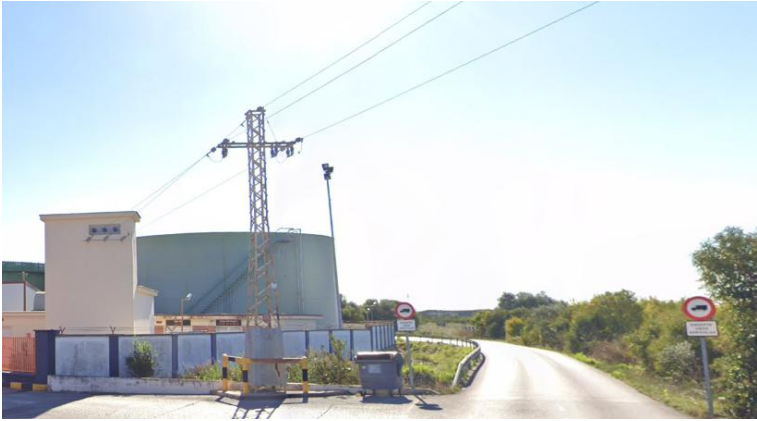
Figura 34 Fotografía de la línea nº 3 de 20 kV y un apoyo, así como la derivación al CT de Repsol.
