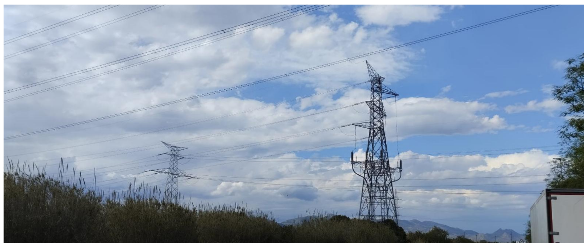
Figura 28 Fotografía tomada desde el vial de acceso a las subestaciones en la que se observa en primer lugar el vuelo de los conductores de la línea nº 1 de 400 Kv, en segundo lugar, el apoyo de la línea nº 6 de 220 Kv con un entronque aéreo-subterráneo, en tercer lugar, la línea nº 2 de 400 Kv con el apoyo a la izquierda y al fondo la línea nº 3 de 132 Kv con el apoyo detrás del apoyo de la línea nº 6
